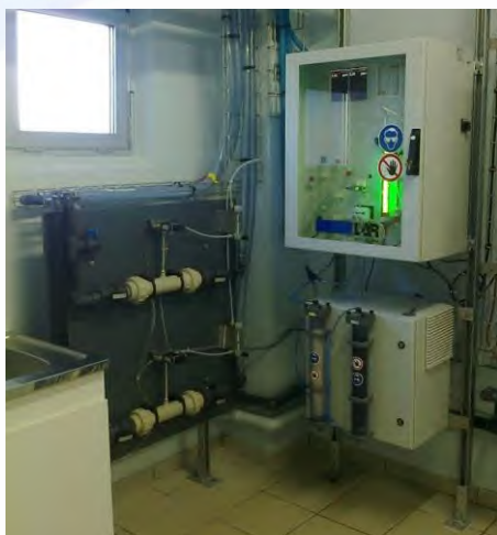
Suivi d'eau de surface et eau potable
